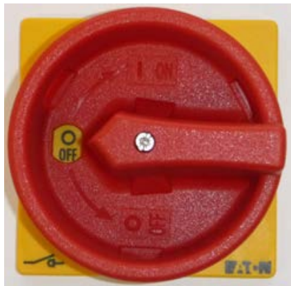
Abb. 54: Hauptschalter auf Stellung "OFF"
